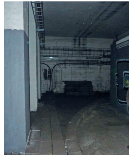
Obr. 5 Prostor středního traktu mezi staničními hloubenými tunely s kabelovými trasami a místností tunelových rozvaděčů – původní stav
